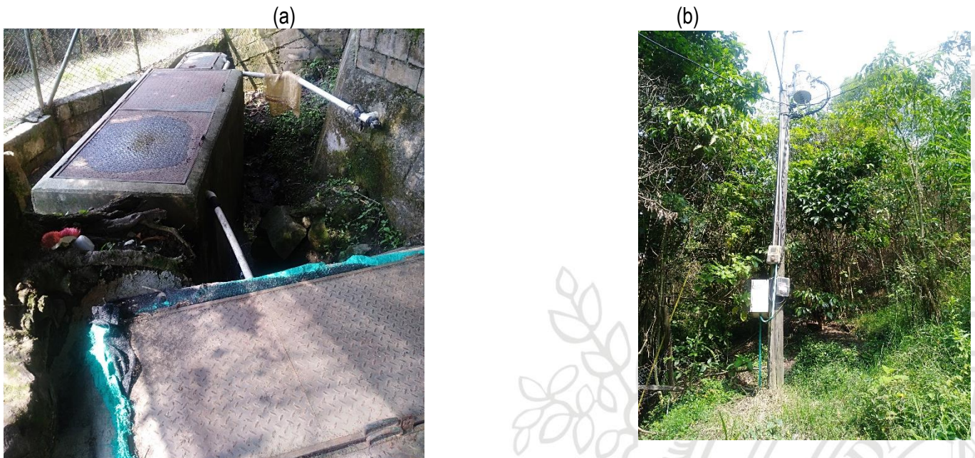
Figura 19 (a)(b): Sistema de captación por método de bombeo Fuente: [Obtención propia].
