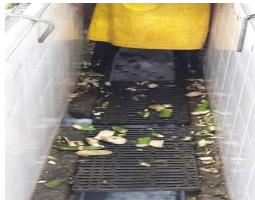
Fotografía 8. Área de selección con rejillas faltantes.
