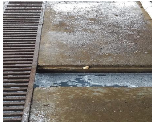
Fotografía 20. Área empacadora con rejillas faltantes.
