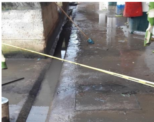
Fotografía 7. Pasillo entre patio de rechazo y tangué de desmane con alta humedad.
