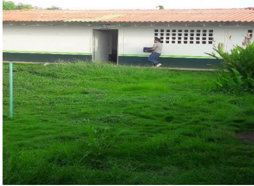
Fotografía 17. Unidades sanitarias sin suministro de agua (se llevó agua del proceso).
