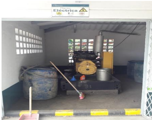
Fotografía 21. Área planta eléctrica con alto desorden.
