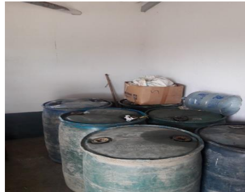
Fotografía 22. Área planta eléctrica usada como bodega de almacenamiento de combustible (sistema de bombeo).
