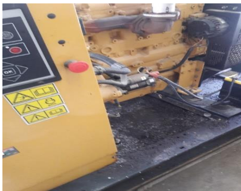
Fotografía 25. Planta eléctrica con residuos de excremento.
