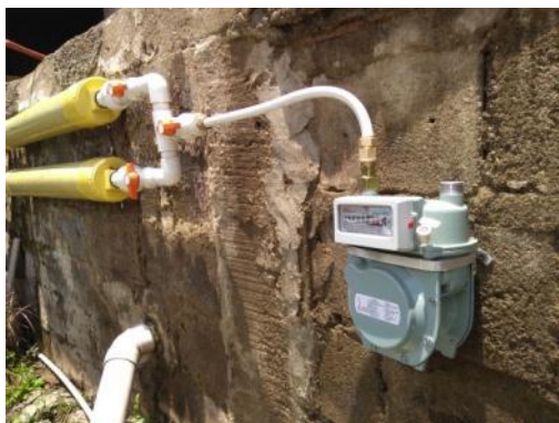
Imagen 32. Conexión sistema de limpieza y medición del biogás
