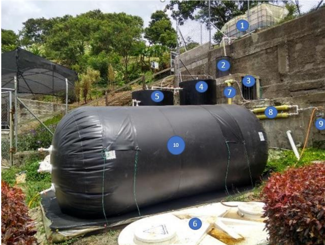
Imagen 40. Sistema de digestión anaerobia instalado
