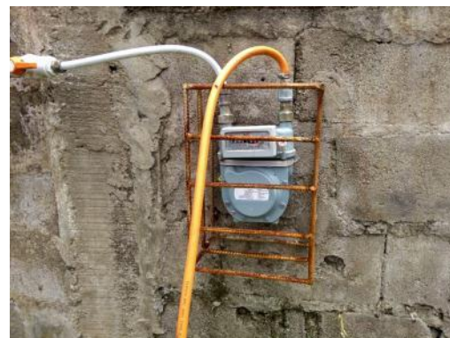
Imagen 33. Medidor de biogás
