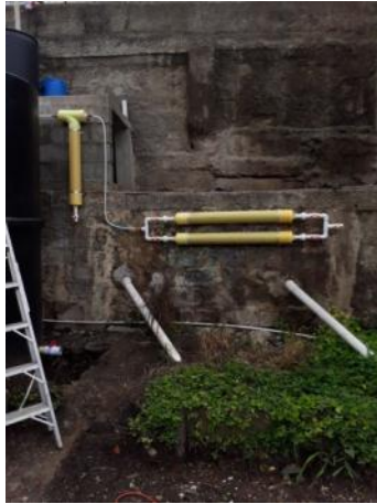
Imagen 29. Sistema de limpieza del biogás
