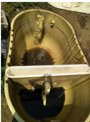
Imagen 28. Tanque de almacenamiento de efluente
