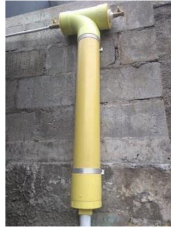
Imagen 30. Trampa de humedad
