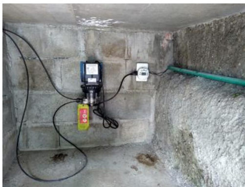
Imagen 22. Sistema de bombeo
