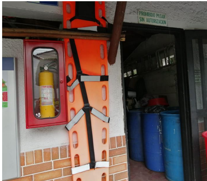
Figura 35. Sistema de control de incendios. Sitio de almacenamiento Aliadas Zona B
