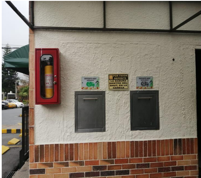
Figura 34. Sistema de control de incendios. Sitio de almacenamiento Aliadas Zona A
