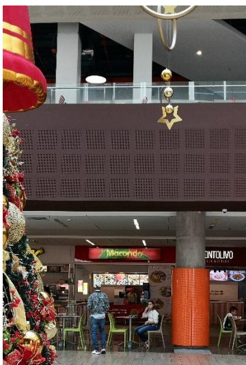
Figura 2. Columna flotante – Discontinuidad vertical
