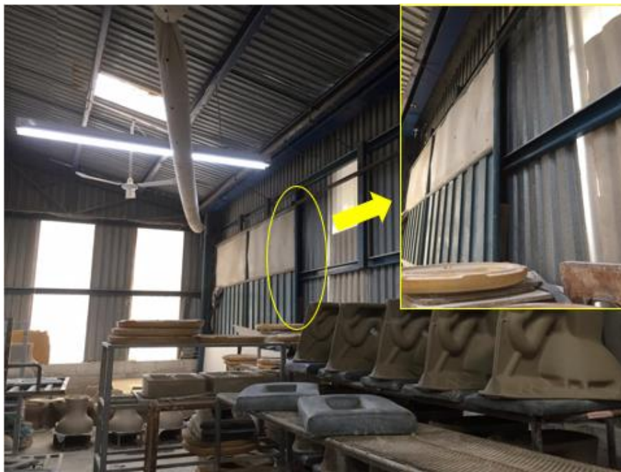
Figura 13. Inconveniente presente en la bodega.
