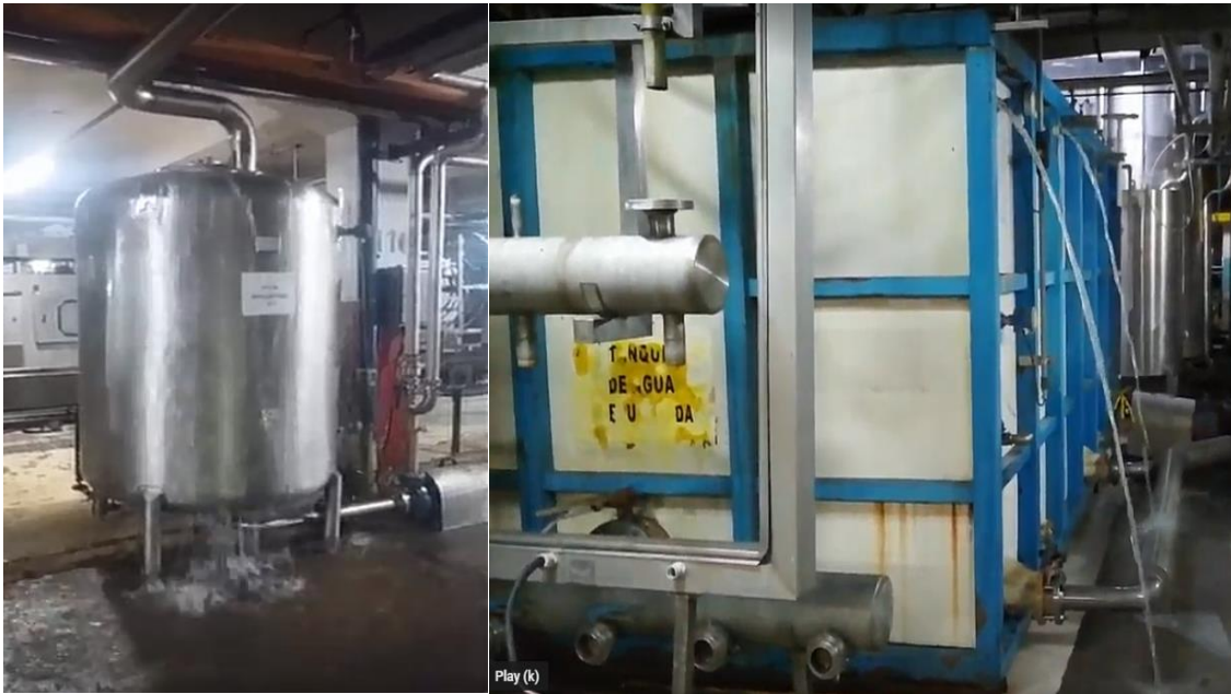
Imagen 5. Reboce de tanques de agua recuperada (tk meta izq. Y tk fibra der.)
