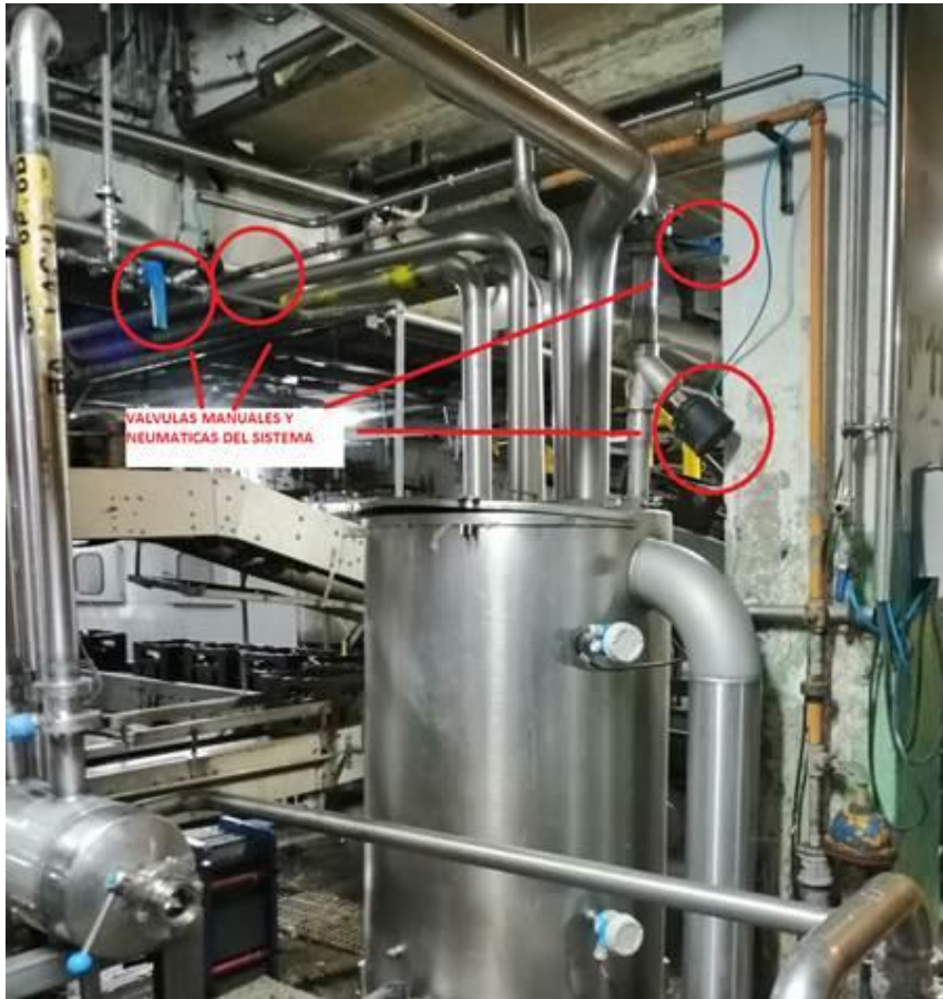
Imagen 6. Foto del sistema de enfriamiento de las bombas de vacío.
