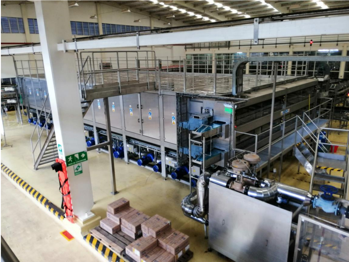
Imagen 7. Sistema de pasteurización de la línea 9. En ese equipo la malta en PET es sometida a altas temperaturas por un tiempo determinado con el objetivo de garantizar un producto libre de microorganismos.
