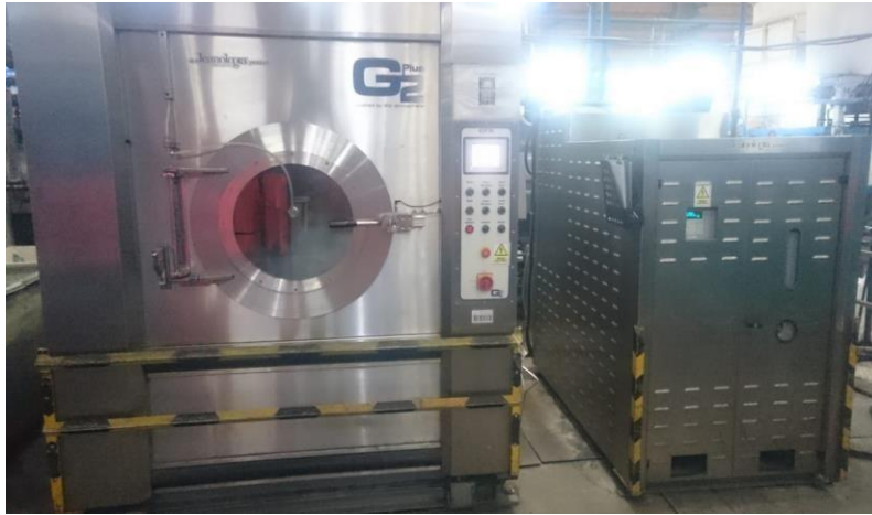
Imagen 2: Equipo generador de ozono ubicado en el lado derecho de la fotografía y al lado izquierdo la lavadora que dosifica.
