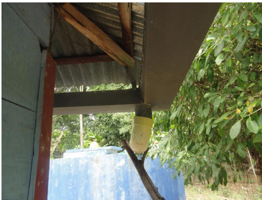
Imagen 55. Casa cosechadora de agua. Por medio del techo de zinc y las canaletas se recoge el agua lluvia y se deposita, a través de un tubo de PVC, al aljibe o tanque de agua de 22.000 litros (pintado de azul). En: Candelaria El Bajo - Lórica. Foto por: Juan Camilo Rojas; noviembre de 2017.
