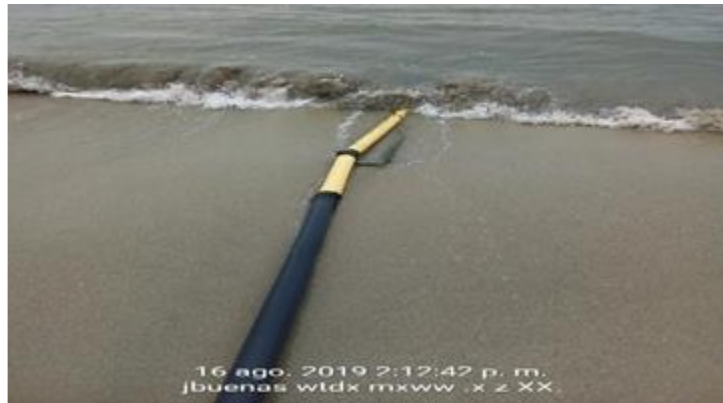
Ilustración 11. Estado tubería emisario marino.
