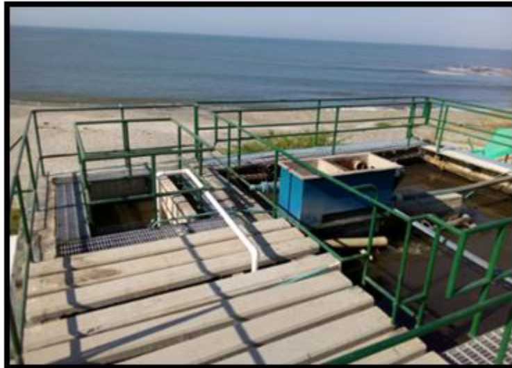
Ilustración 1. Planta tratamiento agua residual
