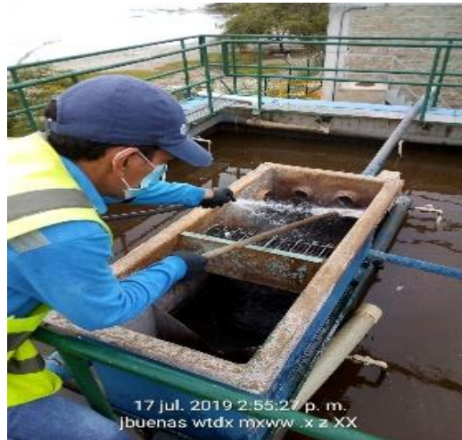
Ilustración 3. Cámara de llegada
