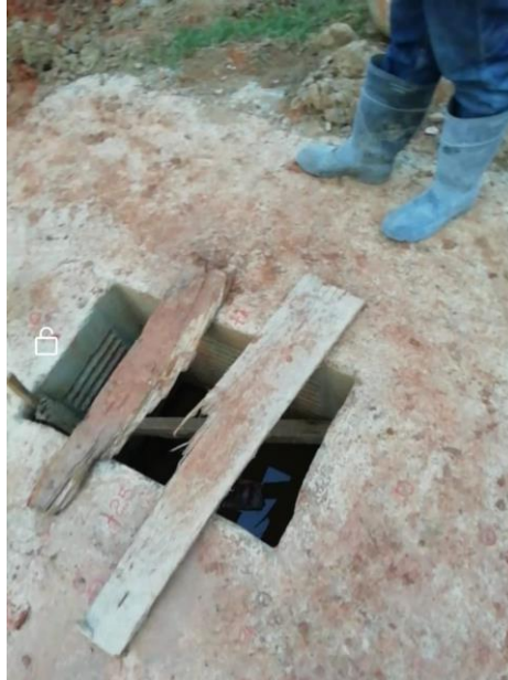
Figura 6. Dado con filtración.
