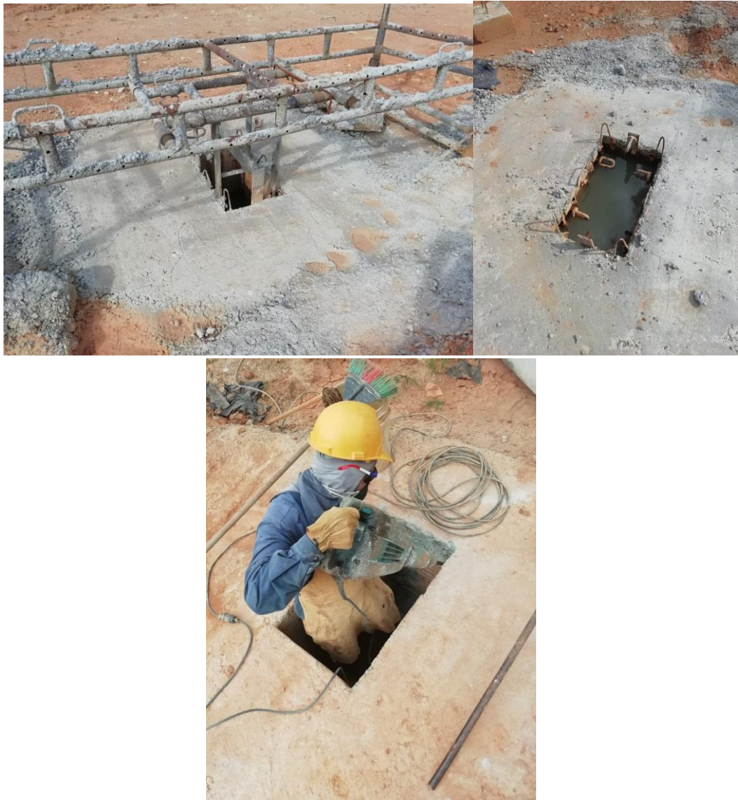
Figura 2. Etapas del vaciado y preparación de un dado de fundación, previas al izaje.
