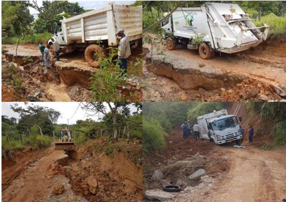
Ilustración 1. Afectación de la vía de acceso al relleno.
