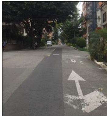
Calle 47 x Carrera 83, vista hacia el occidente. Señales afectadas por parcheo.
