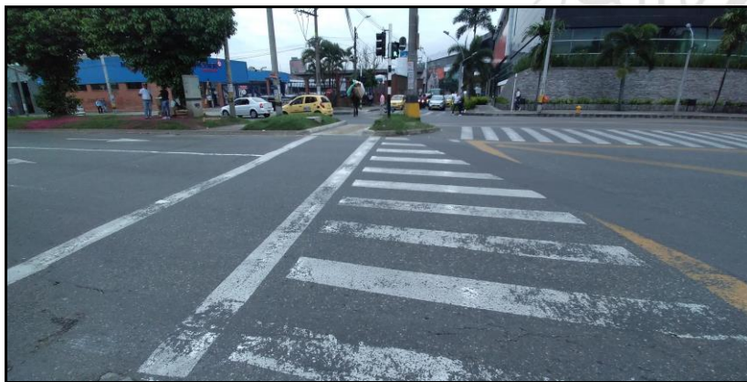
Ilustración 37: Av. Pintuco a la altura de la calle 44, vista hacia el norte – paso cebra en mal estado y sin continuidad. Fuente: Secretaria de Movilidad 2019
