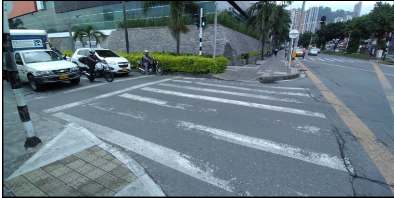
Ilustración 29: Intersección de la Av. Pintuco con Calle 44, costado norte – vista hacia el oriente – pasos cebra en mal estado. Fuente: Secretaria de Movilidad 2019
