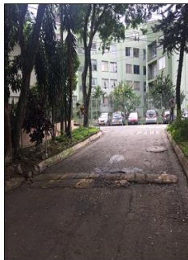
Ubicación de resalto en mal estado sobre la calle 39B, vista hacia el occidente.
