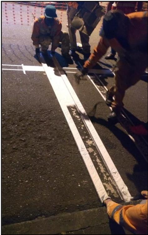
Ilustración 25: Cuadrilla realizando las actividades de demarcación de celdas y señalización horizontal sobre la Calle 8 entre carreras 35 y 36 el 11/04/2019
