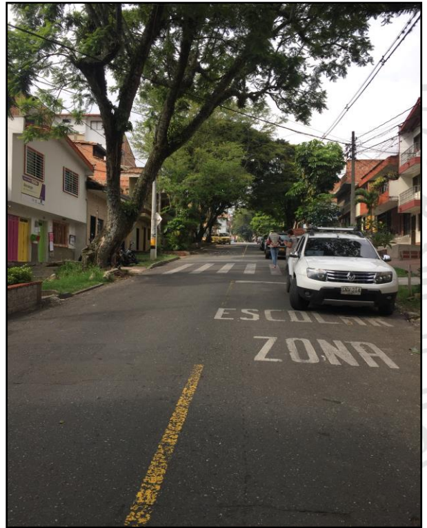
Ilustración 9: Leyenda ZONA ESCOLAR mal demarcada, y demarcación de paso cebra y línea de detención en regular estado, vista hacia el sur
