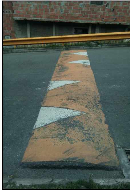
Ilustración 16: Resalto bien demarcado, pero con pintura deteriorada en Carrera 79A # 92-161
