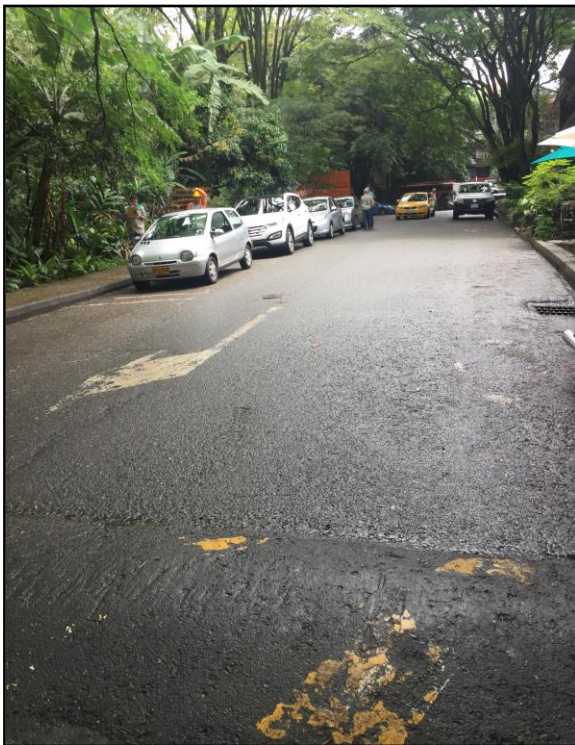
Ilustración 23: Calle 8 entre Carreras 35 y 36 – flecha de giro a la derecha, resalto y celdas en mal estado de conservación, vista hacia el oriente.
