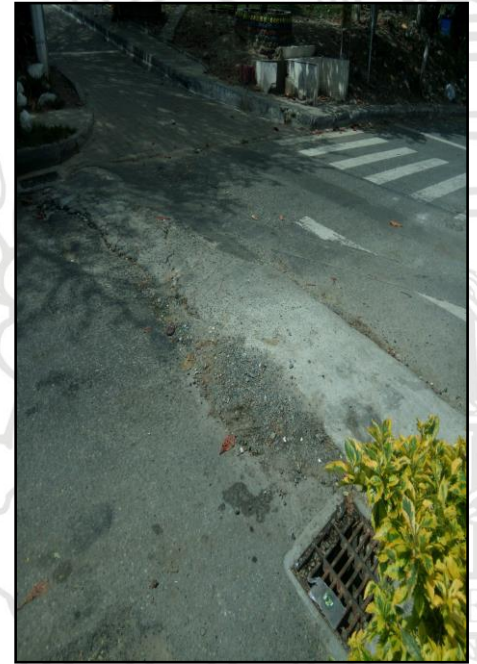
Ilustración 17: Resalto en malas condiciones estructurales en Carrera 82 # 98D-32
