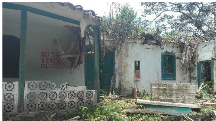
Imagen 4. Casa abandonada - Sector El Taladro. (Autor: Carlos Rosales)
