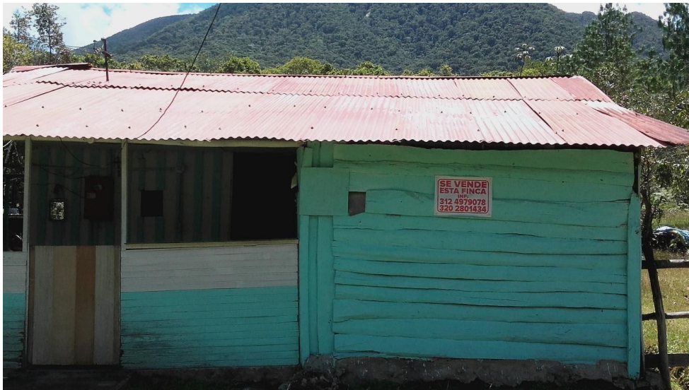
Imagen 3. Casa abandonada - Sector El Taladro. (Autor: Carlos Rosales)
