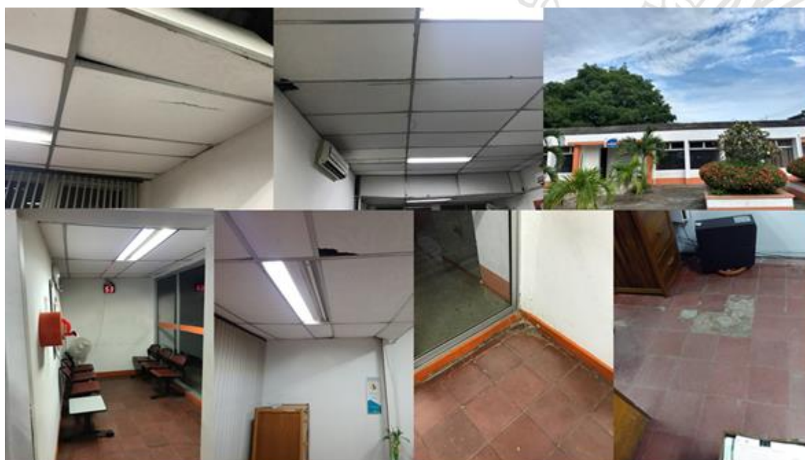
Foto 7. Estado infraestructura 1.1 y 1.2, en la zona de atención
