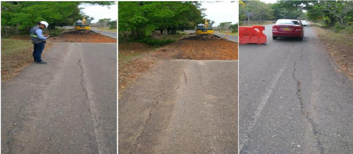
Imagen 2. Grietas presentes en el tramo a rehabilitar de la vía El Viajano-San Marcos, departamento de Sucre. Fuente: Elaboración propia.
