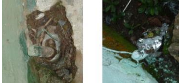
Fig. 18. Sistemas de puesta a tierra deficientes. Tomado de [9].
