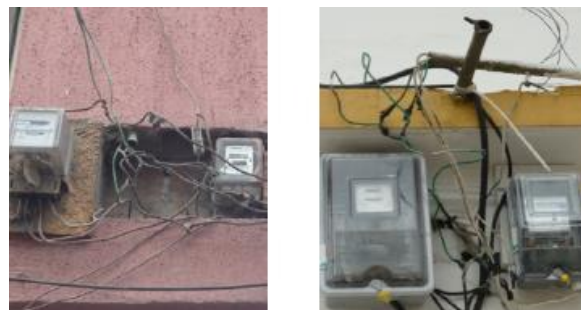
Fig. 17. Malas prácticas de instalación. Tomado de [9].
