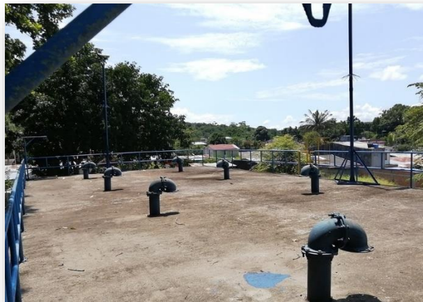
Figura 15. Vista superior del tanque de almacenamiento N° 2 del acueducto del municipio de San Sebastián de Mariquita. (Fuente: Autor)
