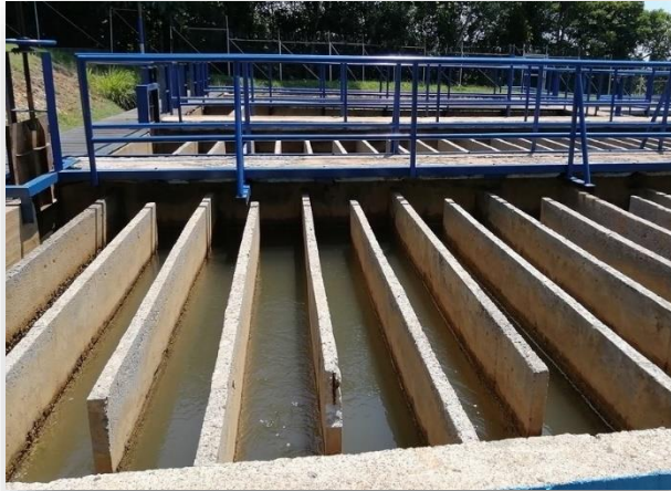
Figura 9. Vista 2 de los módulos de floculación de la PTAP del Municipio de San Sebastián de Mariquita. (Fuente: Autor)
