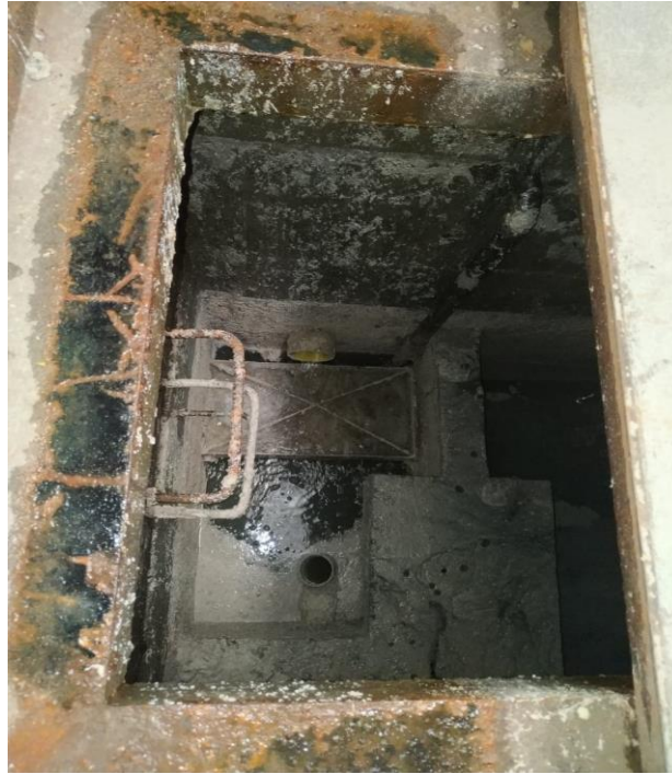
Imagen 4. Tanque trampa de grasas luego de estar en estado de igualación con el tanque homogenizador
