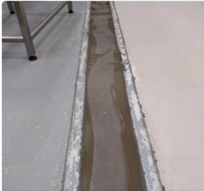
Imagen 3. Canaletas inundadas con agua residual
