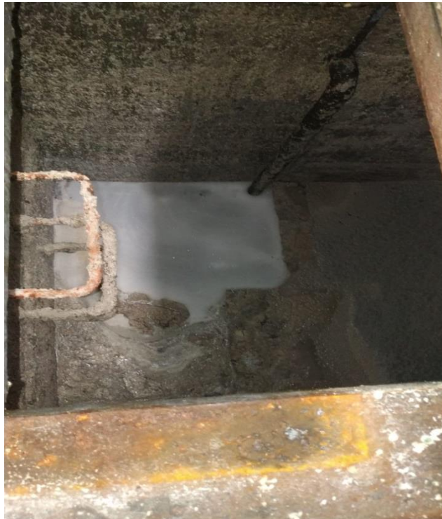
Imagen 1. Tanque trampa de grasas en estado de igualación con el tanque homogenizador
