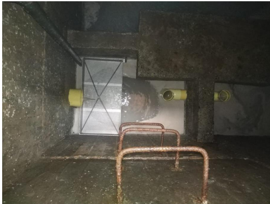
Imagen 7. Trampa de grasas sin presentar estado de rebosamiento
