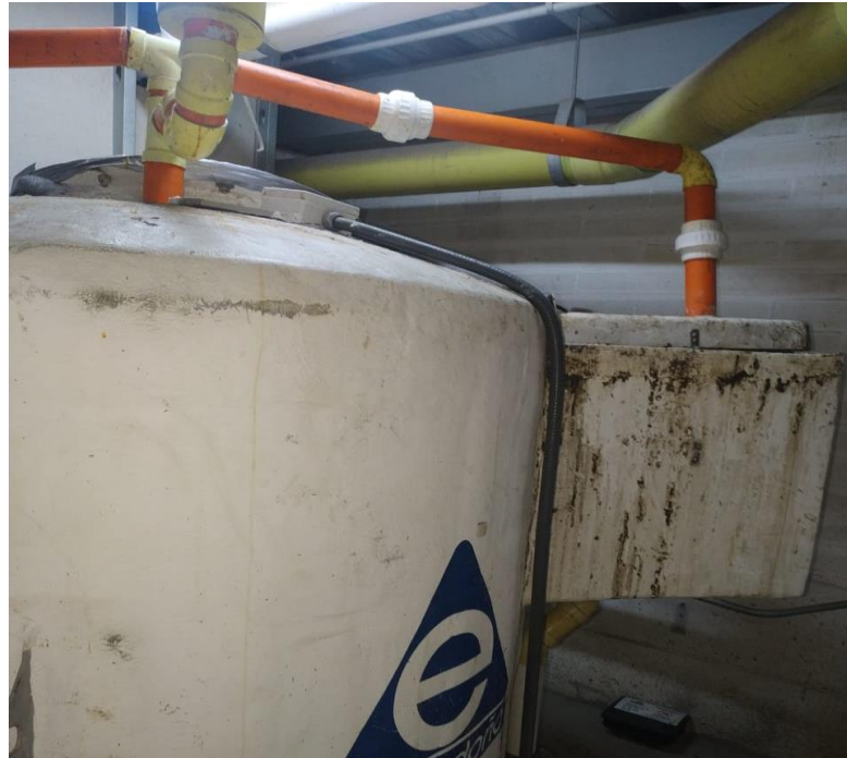
Imagen 5. Reactor UASB en estado de rebose
