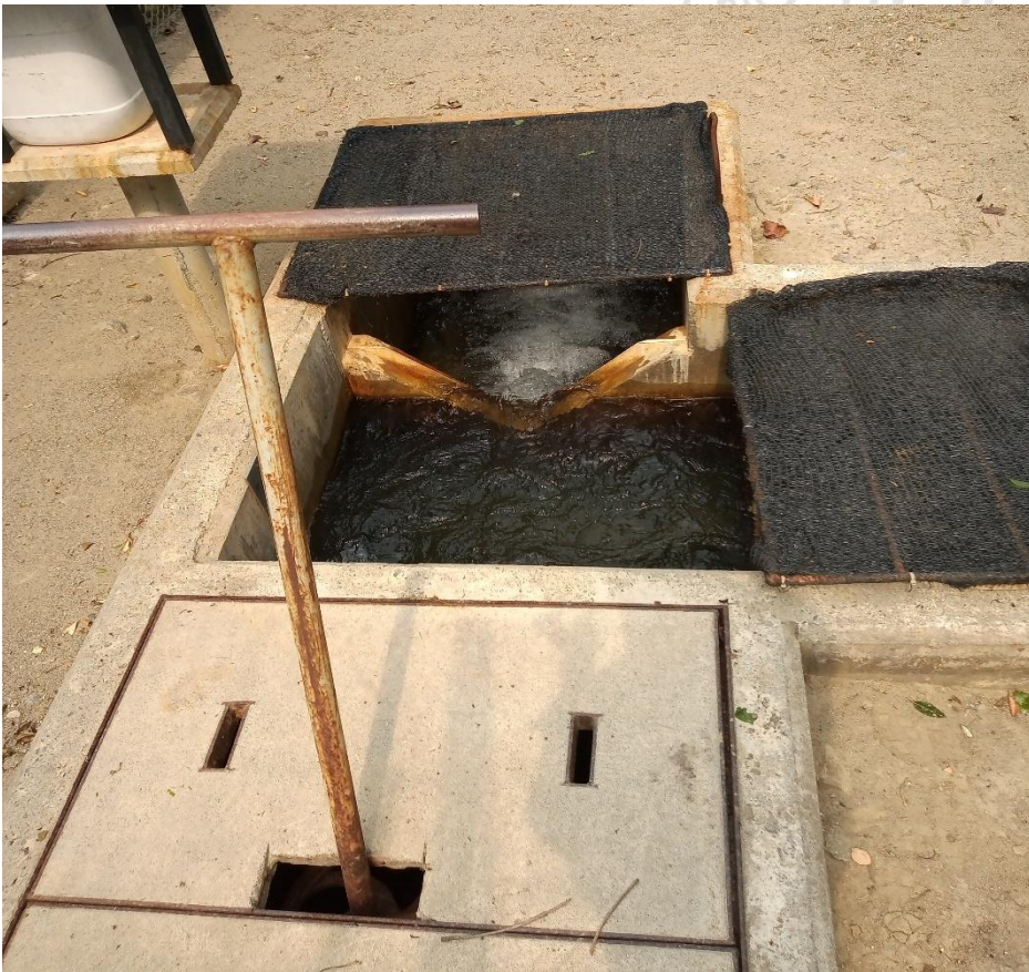
Foto 2. Caja de derivación.
