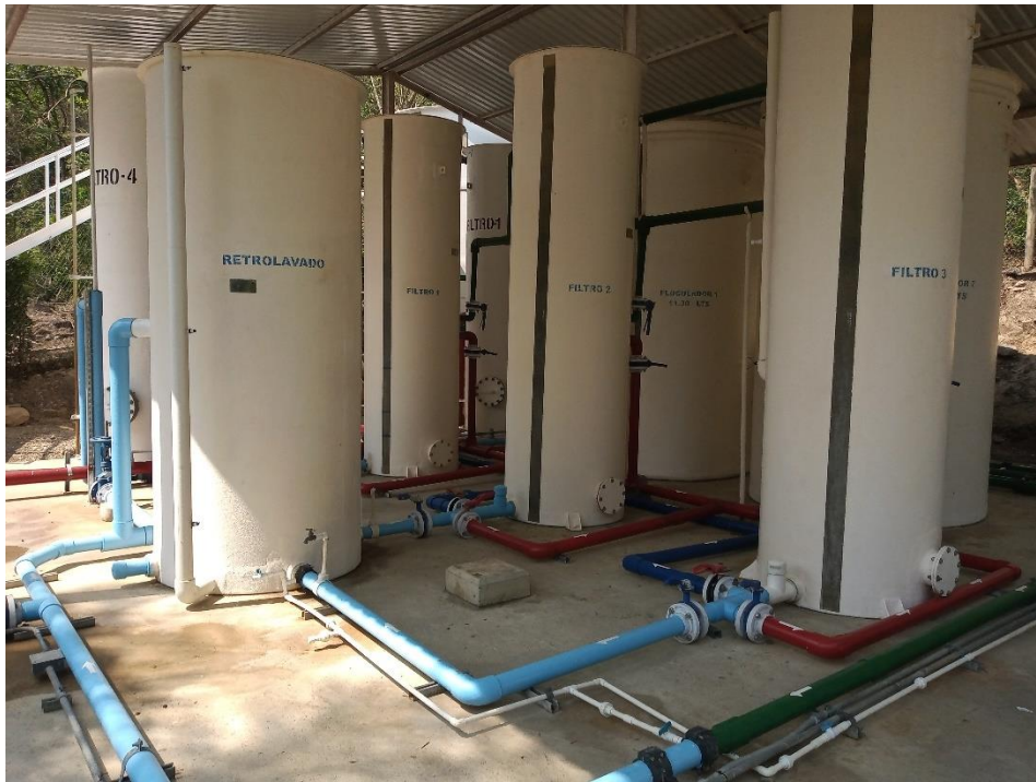
Foto 4. Sistema de tratamiento.
