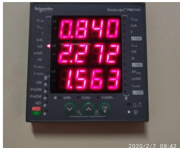
Imagen 14. Potencia medida en el analizador.
