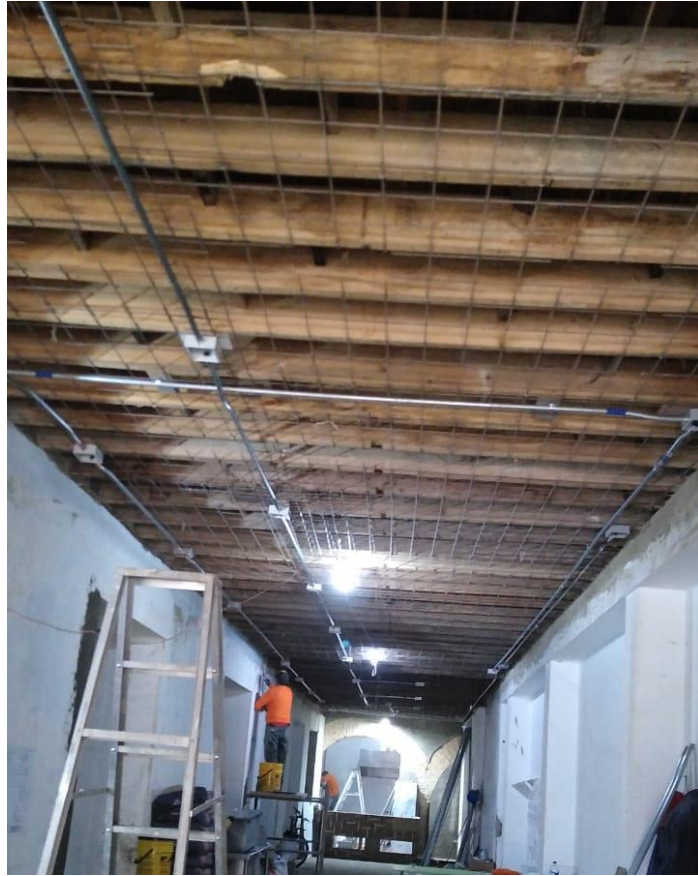
Imagen 6. Tubería expuesta instalada en techo.
