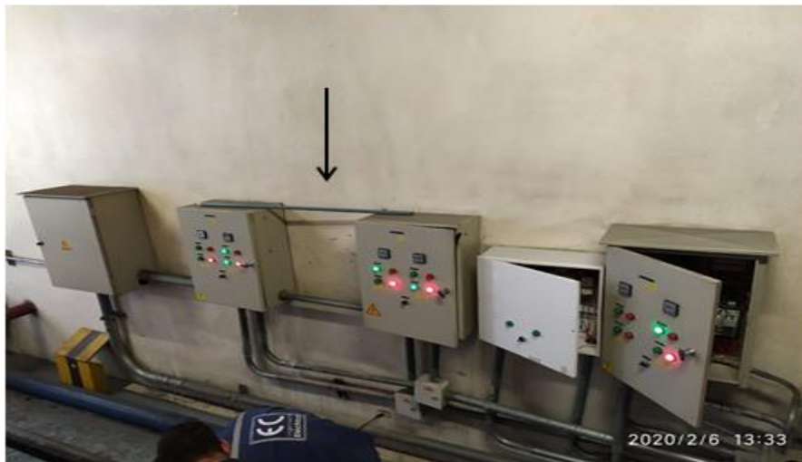
Imagen 8. Ubicación de tablero para analizadores.
