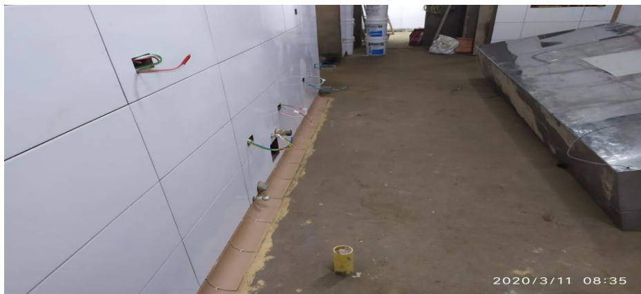
Imagen 7. Salidas de cocina cableadas.
