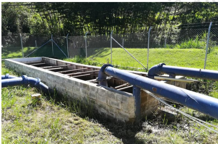
Imagen 19. Tanque de almacenamiento fallado.
