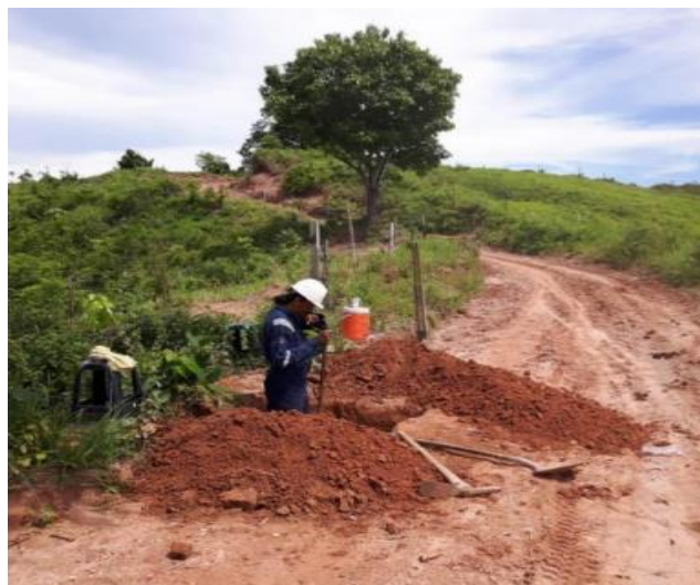
Ilustraciones 12: Apiques realizados en el Proyecto. Fuente: Municipio de Yondó.
