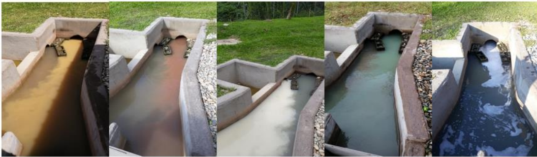
Imagen 9. Descargas inusuales en la PTAR del municipio de San Carlos Fuente: Informe técnico 2 PTAR San Carlos
