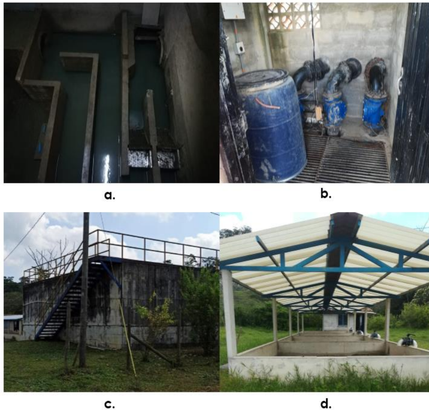
Imagen 5. Unidades de tratamiento en el municipio de San Roque. a. Tratamiento preliminar b. Estación de bombeo c. Reactor UASB d. Lechos de secado
