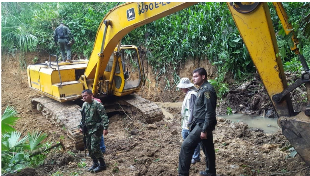
Figura N°4. Apertura de un nuevo camino de forma ilegal.
