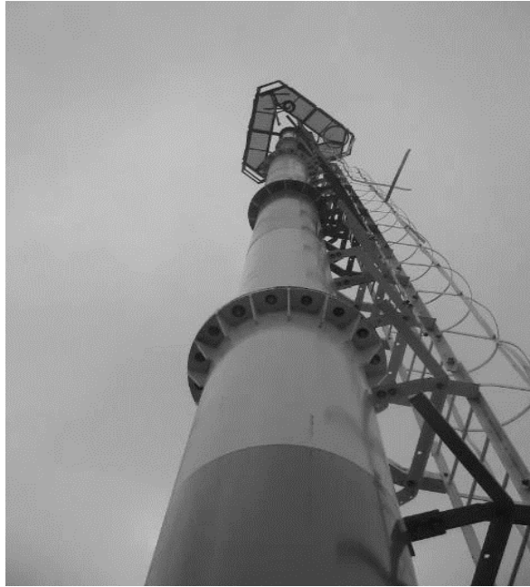
Imagen 8. Estructura de un monopolo. Tomado de: https://companycorp.wixsite.com/menicsa/torres-y-monopolos?lightbox=dataItem-igxw3feo
