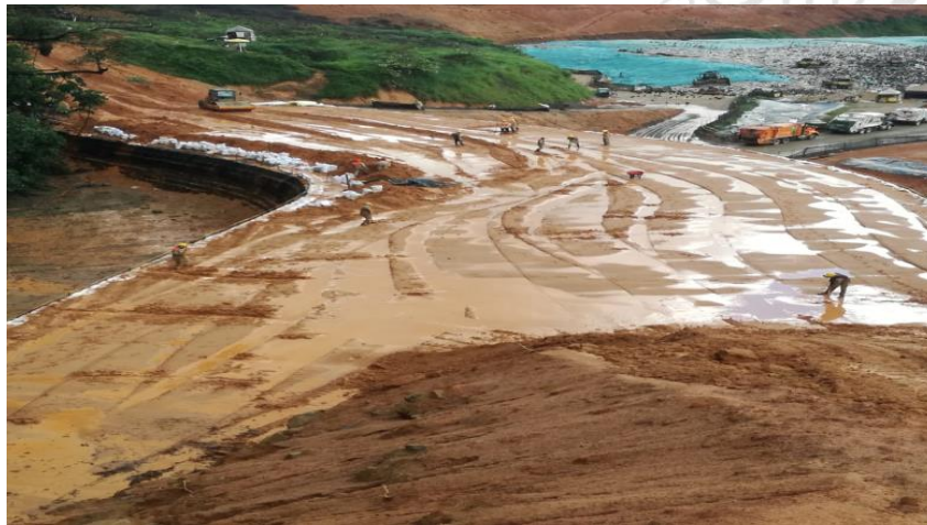
Imagen 13 Capa de terraplén después de fuertes lluvias
