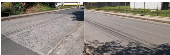
Ilustración 27. Estado del pavimento calle 21 entre carreras 13 y 17
