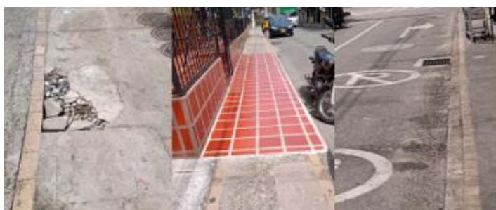
Ilustración 50. Estado del pavimento calle 8a entre carreras 20 y 21
