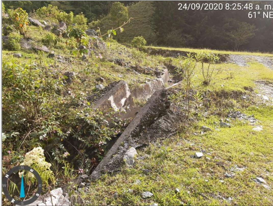
Figura 11: Cuneta afectada por los procesos morfodinámicos
