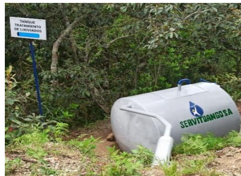
Figura 10. Tanque tratamiento de lixiviados. Después.
