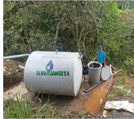
Figura 12. Tanque en funcionamiento.
