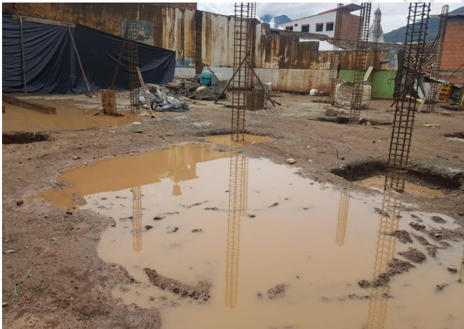
Figura 11 Lluvia en excavaciones.
