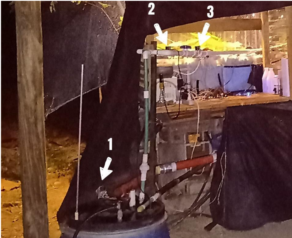
Figura 29 Electroválvulas instaladas en el sistema.
