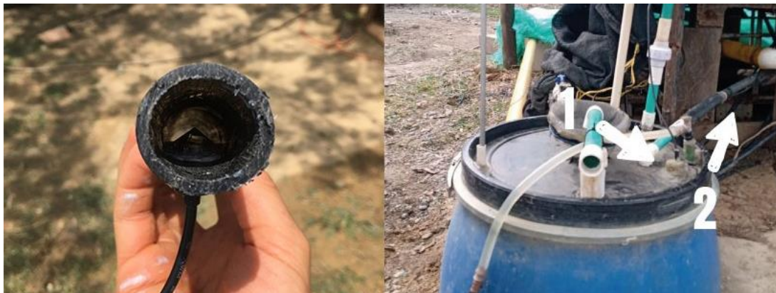
Figura 26 Sensor de nivel óptico implementado (FS-IR02), en la imagen derecha se muestra el lugar en el cual los sensores de nivel fueron instalados (Tanque de reserva (1) y salida de cama de siembra (2)).
