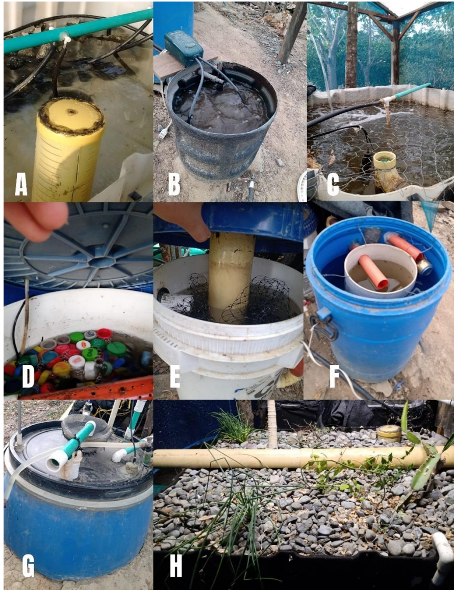
Figura 12 Módulos del sistema. Cifón cama de siembra (A), mineralizador aeróbico (B), tanque peces (C), biofiltro (D), mineralizador anaeróbico (E), sedimentador (F), tanque reserva (G) y cama de siembra (H)
