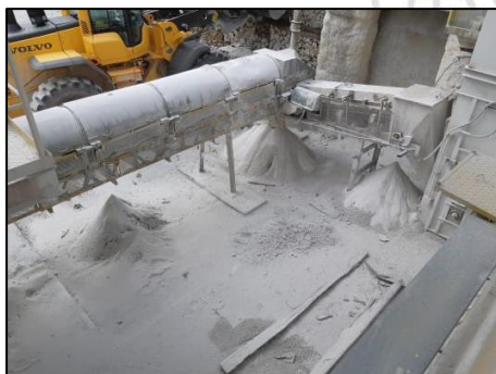
Figura 5 Bandas transportadoras 4 y 5 línea de trituración primaria COSO
