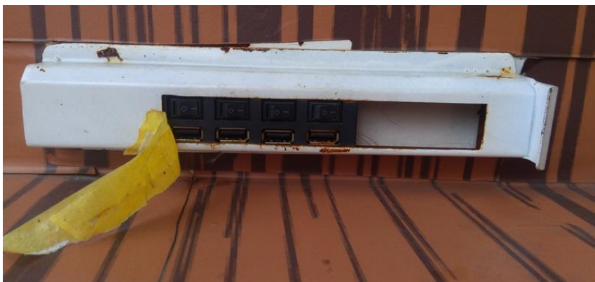
Figura 8. Elemento de las estaciones solares que debía ser reparado, se pueden observar zonas con corrosión debido a la exposición al medio ambiente.
