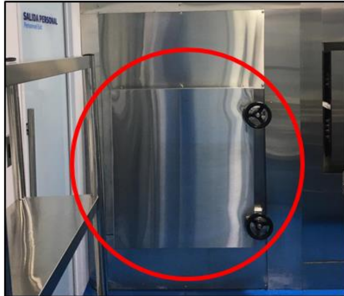
Figura 11. Horno de despirogenización modificado. Nota: en el círculo rojo se muestra cómo se encuentra el equipo modificado [Realización propia]
