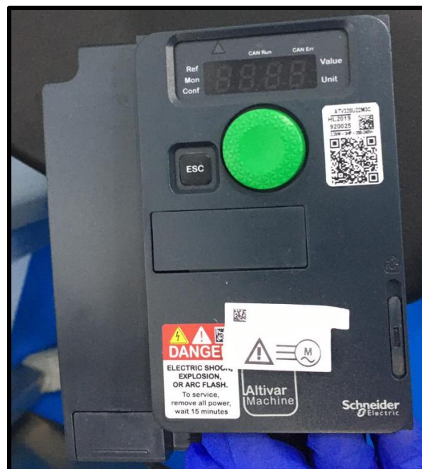
Figura 22. Variador bomba peristáltica de 45 L [Realización propia].
