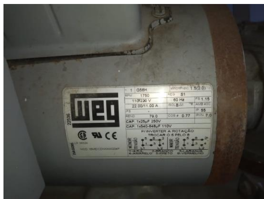
Figura 11. Maquinaria sin uso (Motor).
