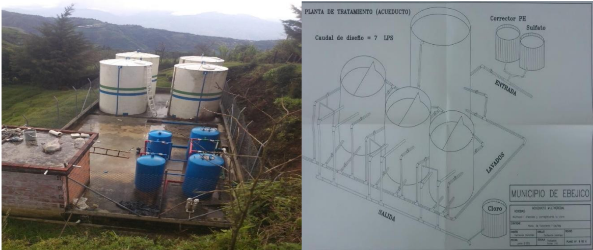
Figura 6. Planta de tratamiento.
