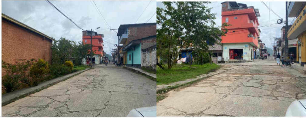
Ilustración 9 Estado vía alterna del Municipio de San Carlos, Antioquia
