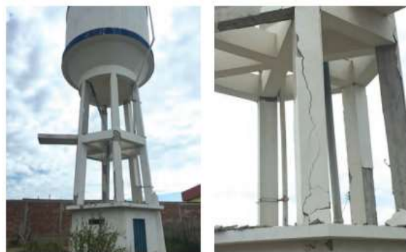
Figura 1-4 Daño en tanque por sismo de Ecuador
