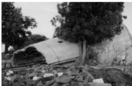
Figura 1-3 Daño en tanque por sismo
