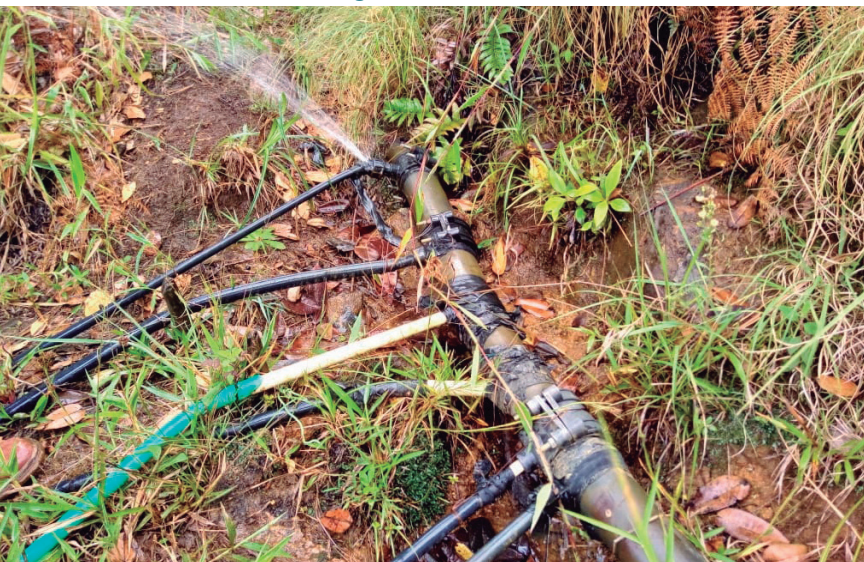
Cambio de manguera e instalación del sistema de flautas. Convites del barrio Bello Oriente
