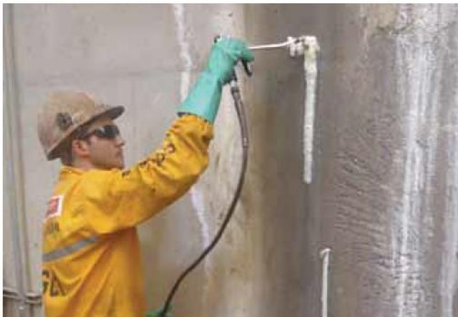
Ilustración 2. Fisuras con presencia de agua selladas en estribo de puente.
