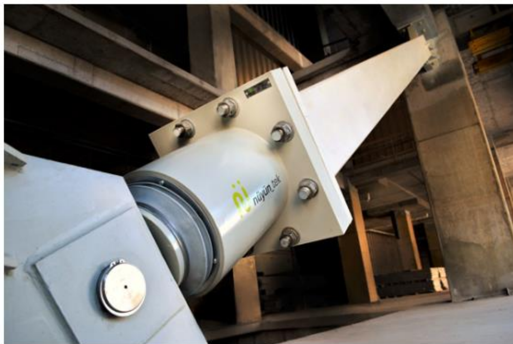
Ilustración 15. Disipador de Fluido Viscoso (Edificio Patio Panorama Chile).
