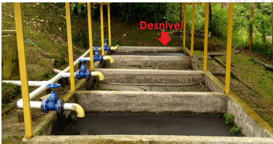
Figura 9. Desnivel evidenciado en una de las celdas de secado de PTAR Granada
