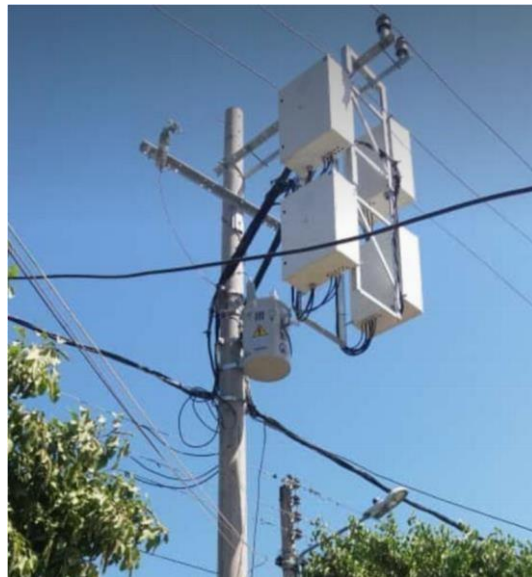
Figura 3. Caja concentradora instalada.
