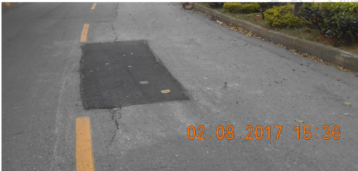
Imagen 1 Parcheo de hueco sobre la calzada Fuente: SIF
