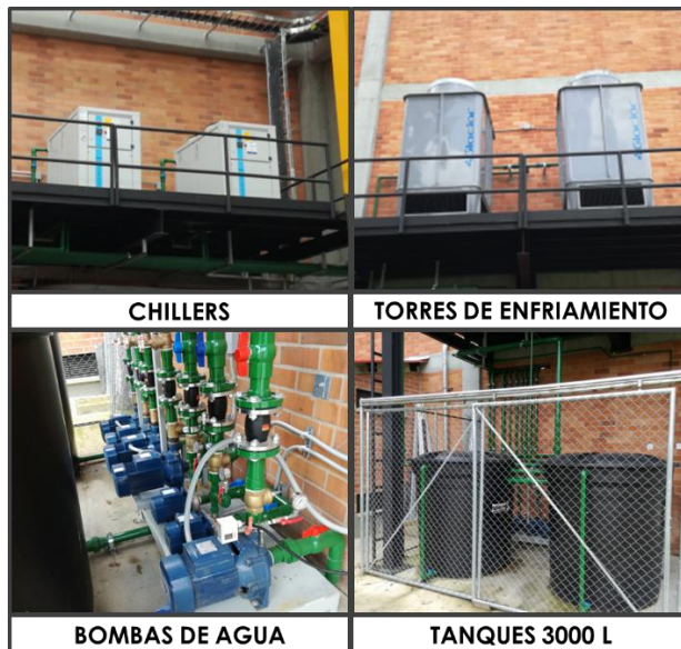
Figura 3. Equipos del sistema de enfriamiento
