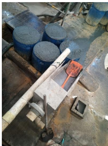
Ilustración 6. Sistema de evacuación del lodo.
