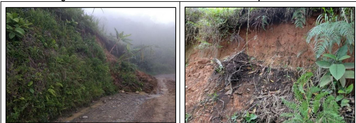
Fotografía 1. Deslizamientos encontrados en la vía Campamento-Anorí
