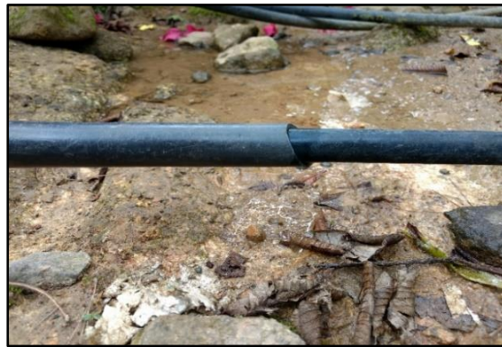
Fotografía 7. Tubería existente en las veredas Plan de la Rosa.
