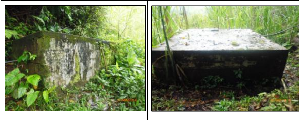
Tanques de almacenamiento presentes en la vereda El Barcino, para almacenar el agua recolectada de los nacimientos mediante mangueras para el abastecimiento de aproximadamente 10 viviendas.
