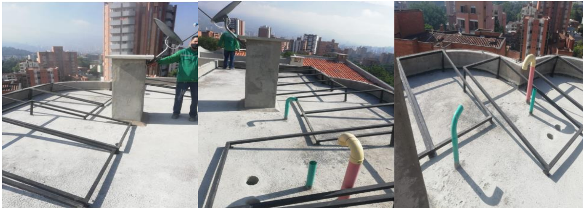
Soportes para paneles solares edificio Hojarasca
