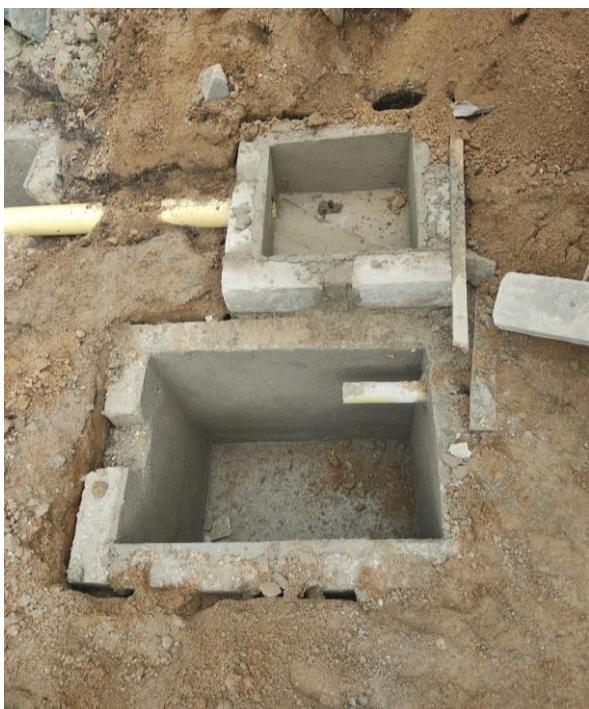
Levantamiento de muros y suministro de pañete cajilla de inspección y trampa de grasa
