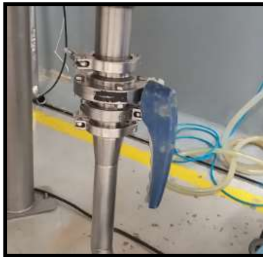
Imagen 11. Válvulas manuales, Doy pack automática Panal S.A.S Fuente: Planta Panal S.A.S
