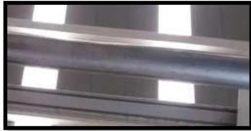
Imagen 6. Tubería acero inox 2" Doy pack automática Panal S.A.S Fuente: Planta Panal S.A.S
