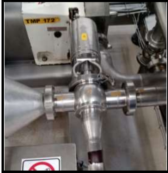
Imagen 12. Válvula automática Panal S.A.S Fuente: Planta Panal S.A.S
