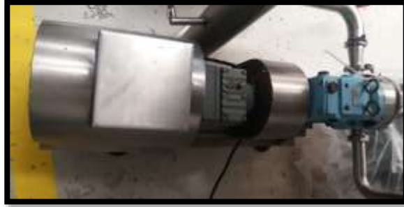
Imagen 10. Bombas de impulsión, Doy pack automática Panal S.A.S Fuente: Planta Panal S.A.S
