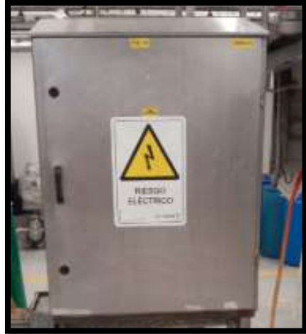
Imagen 8. Tablero eléctrico planta Panal S.A.S Fuente: Planta Panal S.A.S
